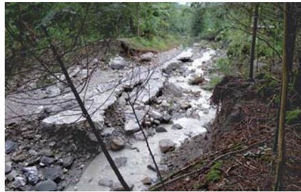
Bild 5. Dürrenbach. Zerstörte Bachschale. Blick in Fliessrichtung. (Foto Bänziger Partner AG).
